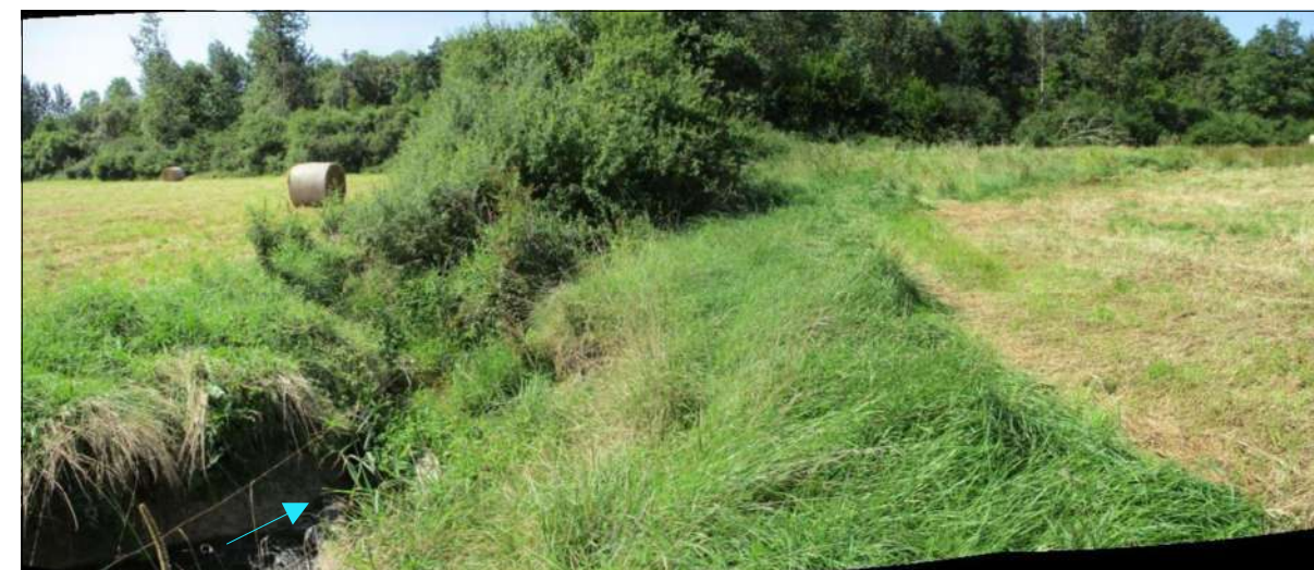
Photo n°13 : Partie aval du fossé issu de la brèche dans le canal d'aménée
